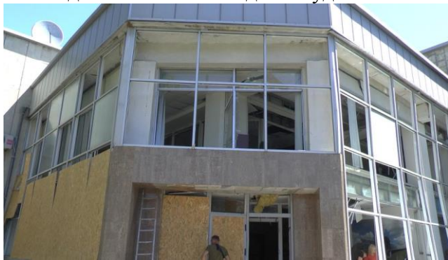
Фасад торговельного центру після обстрілу.
