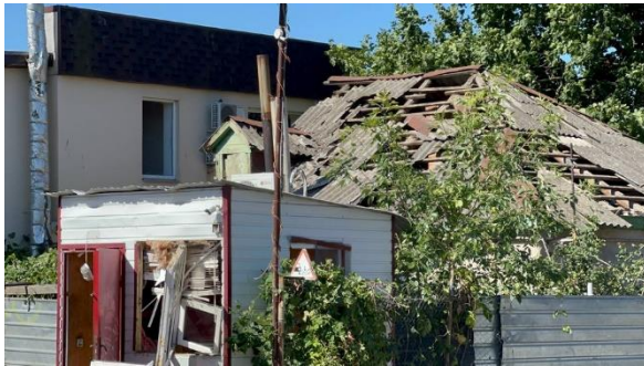
Пошкодження та руйнування після обстрілу. Фото: Єлизавета Кротик/Суспільне Миколаїв
