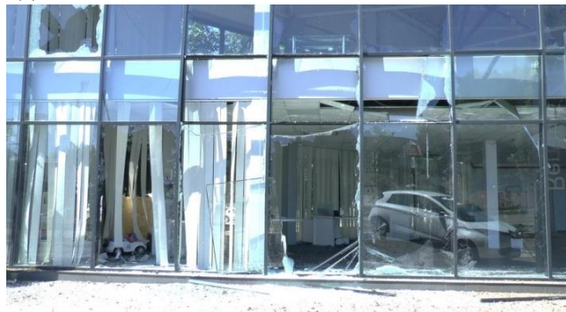
Пошкоджений фасад автосалону.
